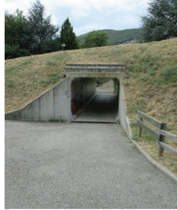
Passages sous voie vers le centre: absence de traitement
